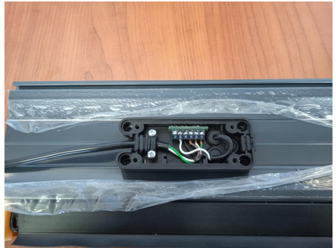
28. Prawidłowo podłączona wtyczka i ułożony kabel.
